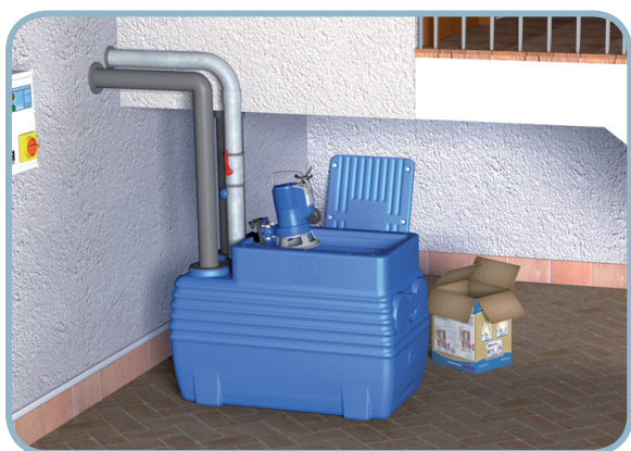
⑤ 水泵联接
